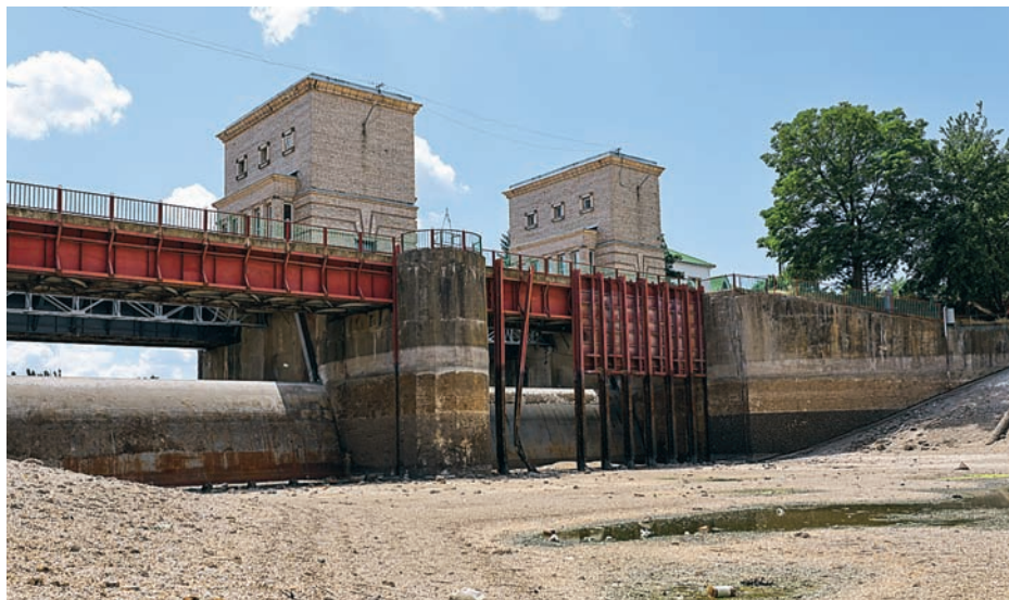
Перекрыт в 2014 году Северо-Крымский канал, Украина лишила Крым основного источника пресной воды. Ответом на вызов стал переход на подземные источники воды и отказ от рисоводства
