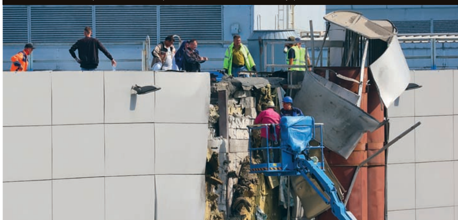
Павильон «Экспоцентра» в Москве, поврежденный обломками сбитого украинского БПЛА
