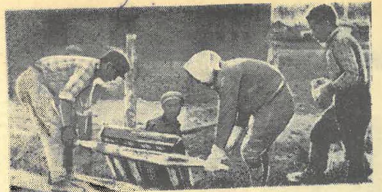
Работа на совхозных стройках была по плечу всем — юношам и девушкам. Вместе носили раствор, рыли траншеи, укладывали саман. На снимке студенты за работой.
